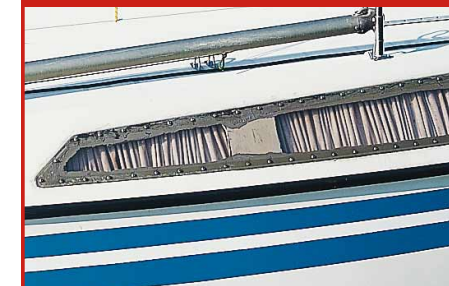
Unsachgemäße Reparaturen des Eigners, wie hier das Dichten des Fensters, sollten nicht akzeptiert werden
